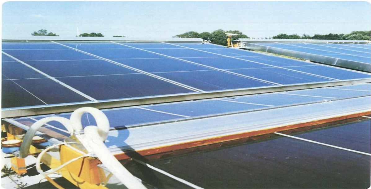
Energie- und Solartechnik bei Dornier
